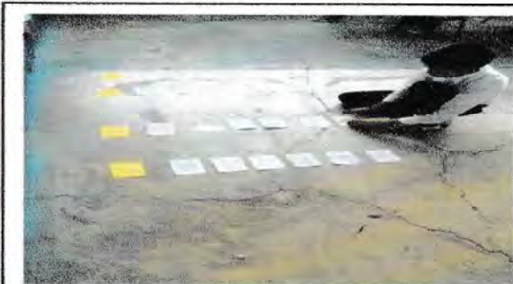
Foto 3: Piso aula No.1 la torta es lisa y tiene muchas grietas en toda el aula, las grietas son profundas y causan siempre que salga tierras de las mismas.
