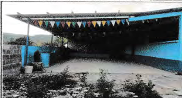
Foto 1: Torta de galera de usos múltiples se encuentra dañada tiene grietas y de esas dependerán más ya que el uso de la galera es constante con actividades.
